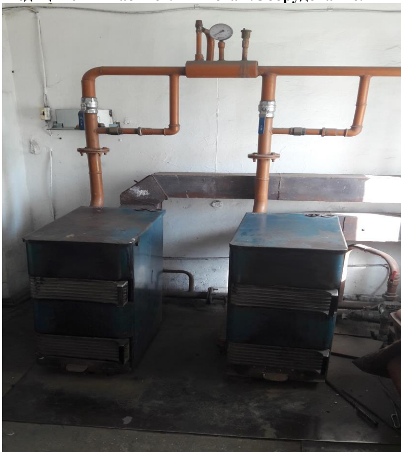
Котельная. Два котла на твердом топливе.
