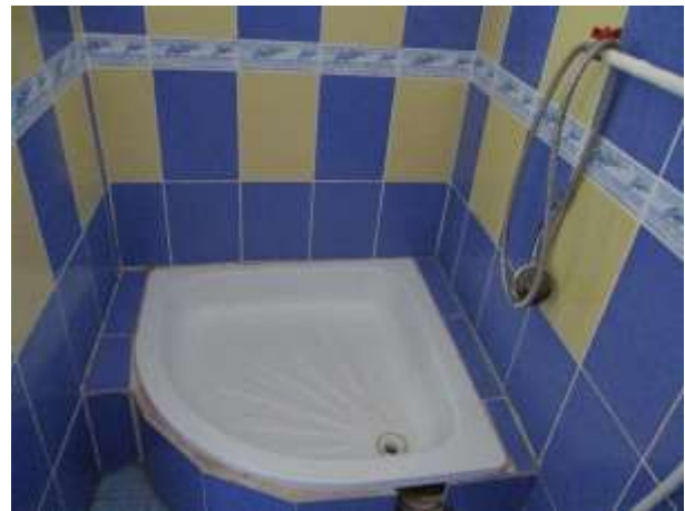
Фото № 16 (б) – Душевая комната
